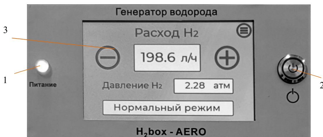
Рис.3. Панель управления генератором водорода H 2 box-AERO
